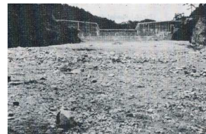
土砂で埋まった五助堰堤(ダム)
